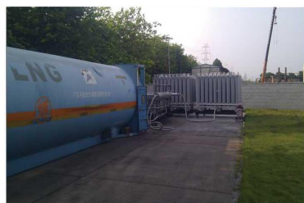
广州东永港华燃气有限公司
