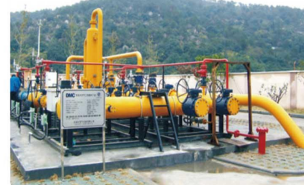
慈溪富茂管道燃气有限公司
