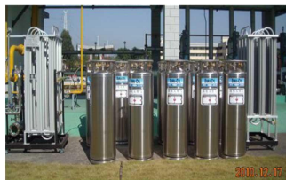
广州东永港华燃气有限公司
